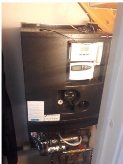
Свързване на сграда към топлофикационната мрежа с помощта на теплообменник
