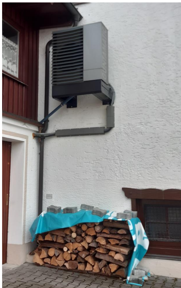
Термопомпа върху стената на къща и съхранение на дърва за огрев на земята
