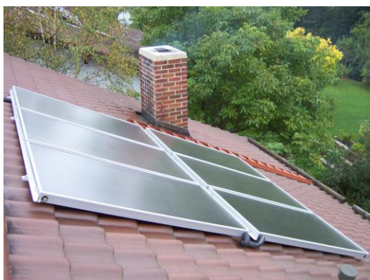
Слънчеви колектори, монтирани върху покрива на еднофамилна къща
