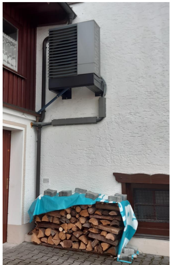
Bomba de calor instalada en la pared de una casa y almacenamiento de leña en el suelo
