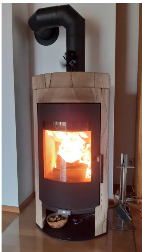
Moderna y eficiente estufa de leña en el salón de una vivienda
