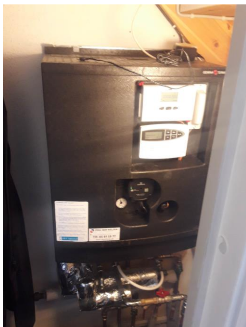
Conexión del edificio a una red de calefacción urbana con un intercambiador de calor
