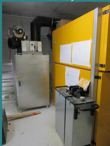
Kotao na drvnu sječku s čišćenjem dimnih plinova Pravo vlasništva: Energiewende
