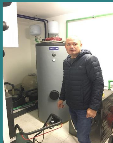
G. Bilobrk ispred kotla za toplu vodu u kotlovnici
