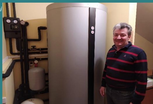
G. Pujić ispred spremnika za toplu vodu u kotlovnici
